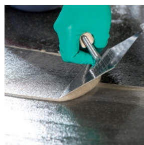
Kras- en vulpleister MC-DUR TopSpeed SC opgevuld met zand
